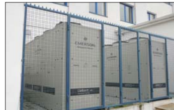
Два чиллера Emerson Liebert HPC с поддержкой технологии Free Cooling работают попеременно с суточным интервалом
