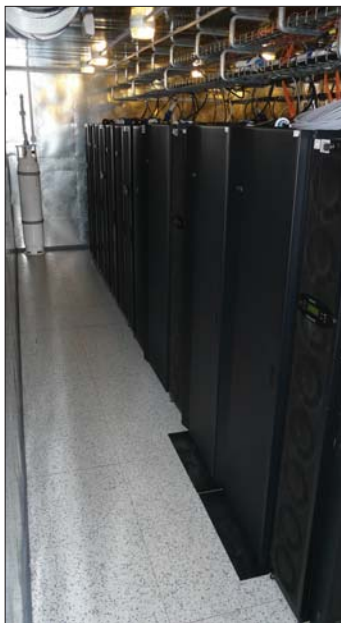
Слева на фото баллон с газом системы пожаротушения, хорошо заметно экранирование стен здания, справа в рядках шкафов выделяются системы внутреннего охлаждения APC InRow и шкафы IBM — единственные с пьедесталами для смещения центра тяжести
