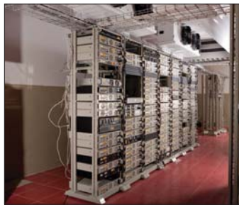
Так сегодня выглядит ЦОД «Бункер» с установленным оборудованием
