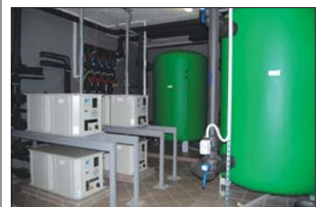
Двухконтурная система охлаждения впечатляет своими масштабами. Резервированные баки обеспечивают 40 мин автономии по хладагенту
