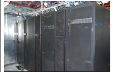
Пример интеграции внутренних блоков систем кондиционирования APC InRow RC с серверными шкафом IBM (резервирование N+1)
