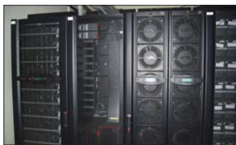
Symmetra PX, батарейный шкаф, кондиционеры
