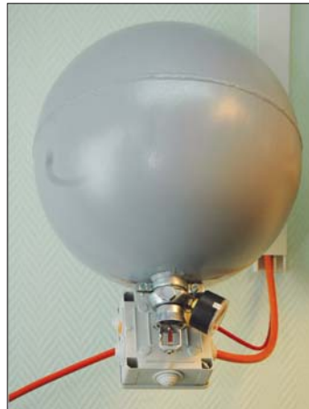
Датчик системы пожаротушения
