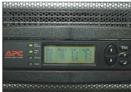
Индикатор системы мониторинга ИБП APC
